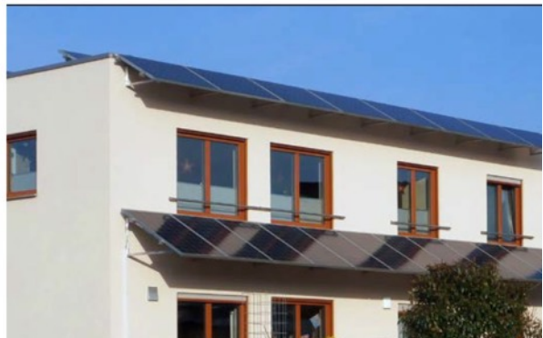
Verschattung durch Solar-Module
